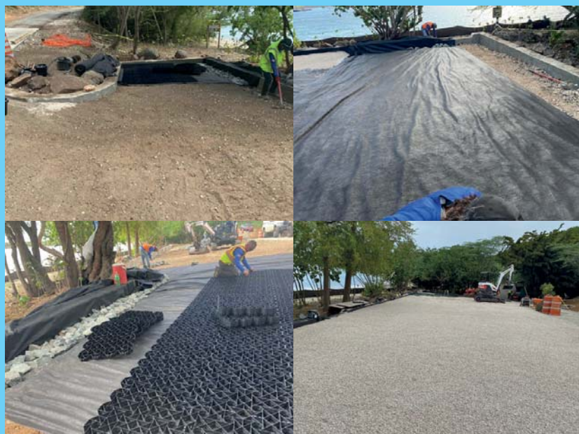
Figure 46 : Le processus de développement du parking perméable de la plage de Tamarindo (Source : PDC)
